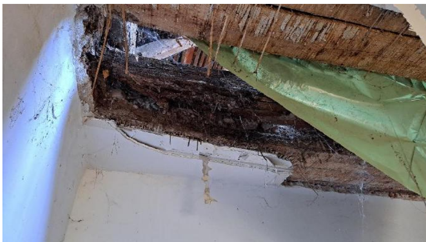
Poškodovan strop zaradi zamakanja strehe Trg svobode 18
