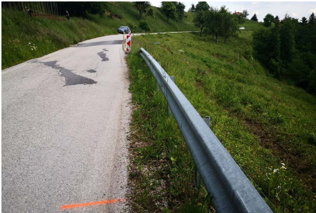
Slika 9: Stanje plazu na LC 440201 Cezlak–Kebelj, pogled proti Keblju
