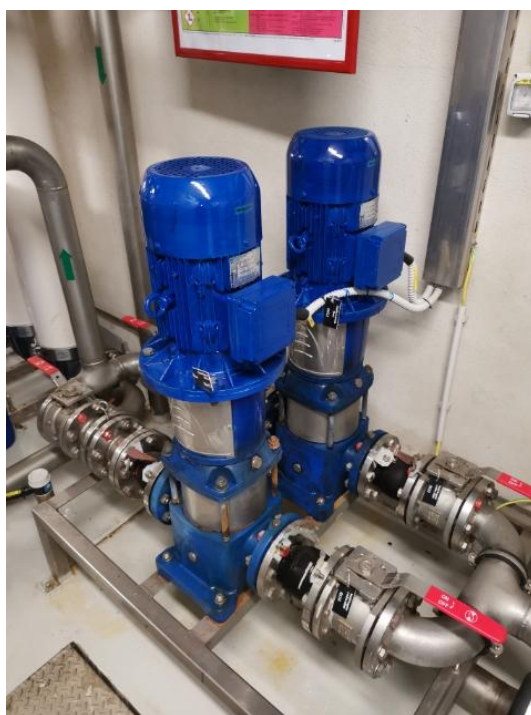
Slika 13: Črpalni blok UF pitne vode Jelovec
