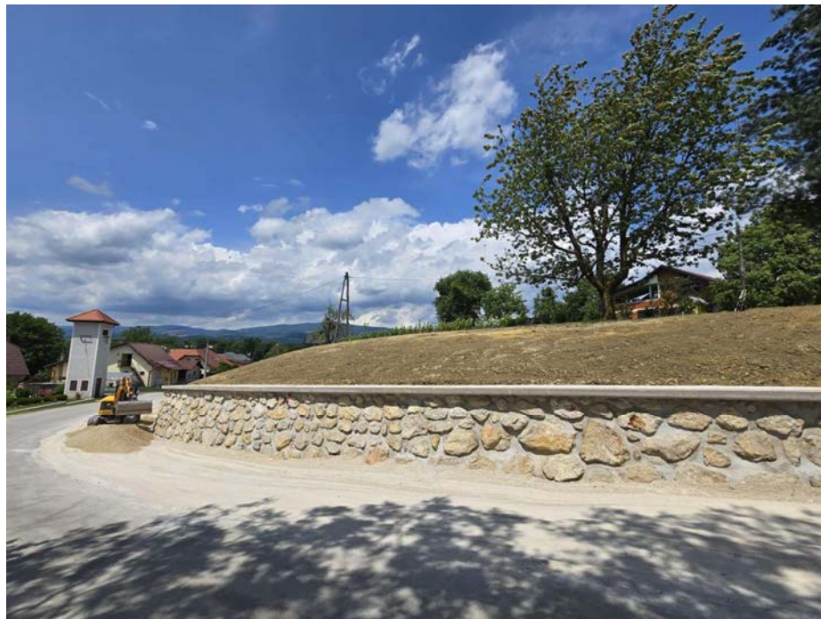
Sanacija plazu ob lokalni cesti Vrhole pri Slovenskih Konjicah
